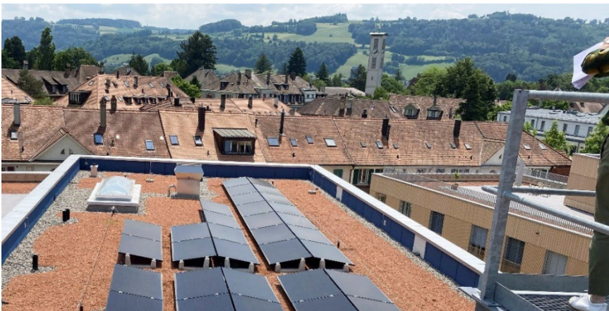
Blick auf die Solarpanels auf dem Dach der Überbauung Burgernziel (T. Göttin)
