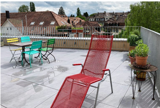
Stelzlager unter den Steinplatten musste verstärkt werden (T. Göttin)
